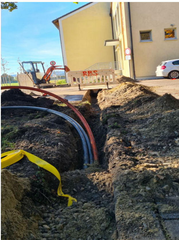
Das Rathaus und die Grund- und Mittelschule werden am Glasfasernetz angeschlossen.
