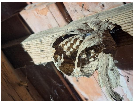
Abbildung 5: Altes Wespennest im Dachboden des Bestands- gebäudes (Aufnahmedatum 19.02.25)
