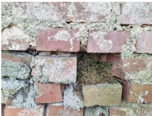
Abbildung 15: Nest an der Nordseite, evtl. Hausrotschwanz (Aufnahmedatum 13.01.25)
