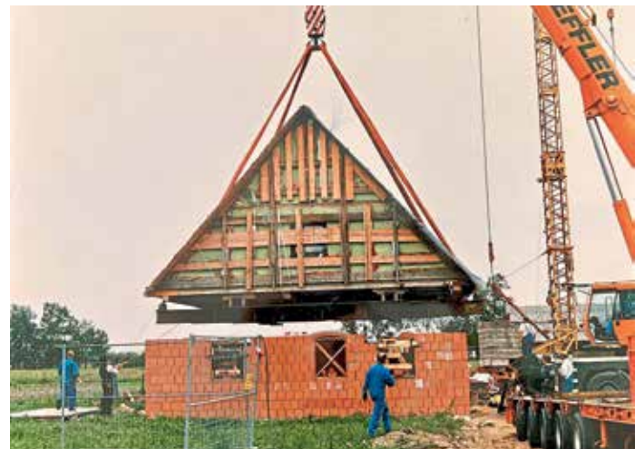
Aufsetzen des historischen Dachstuhls auf dem neuen Erdgeschoss im HAUS im MOOS
